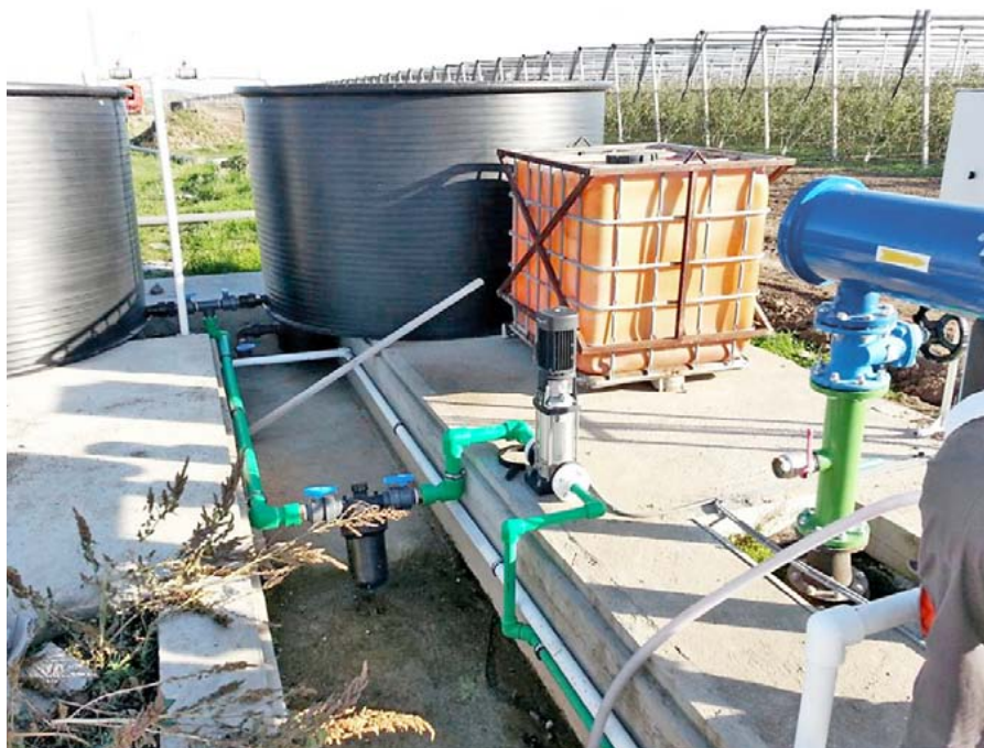
Слика 6 – главна контрола са системом за прихрану са електро напајањем (фаза 1, 2, 3, 4 од 2013–2014 године)
